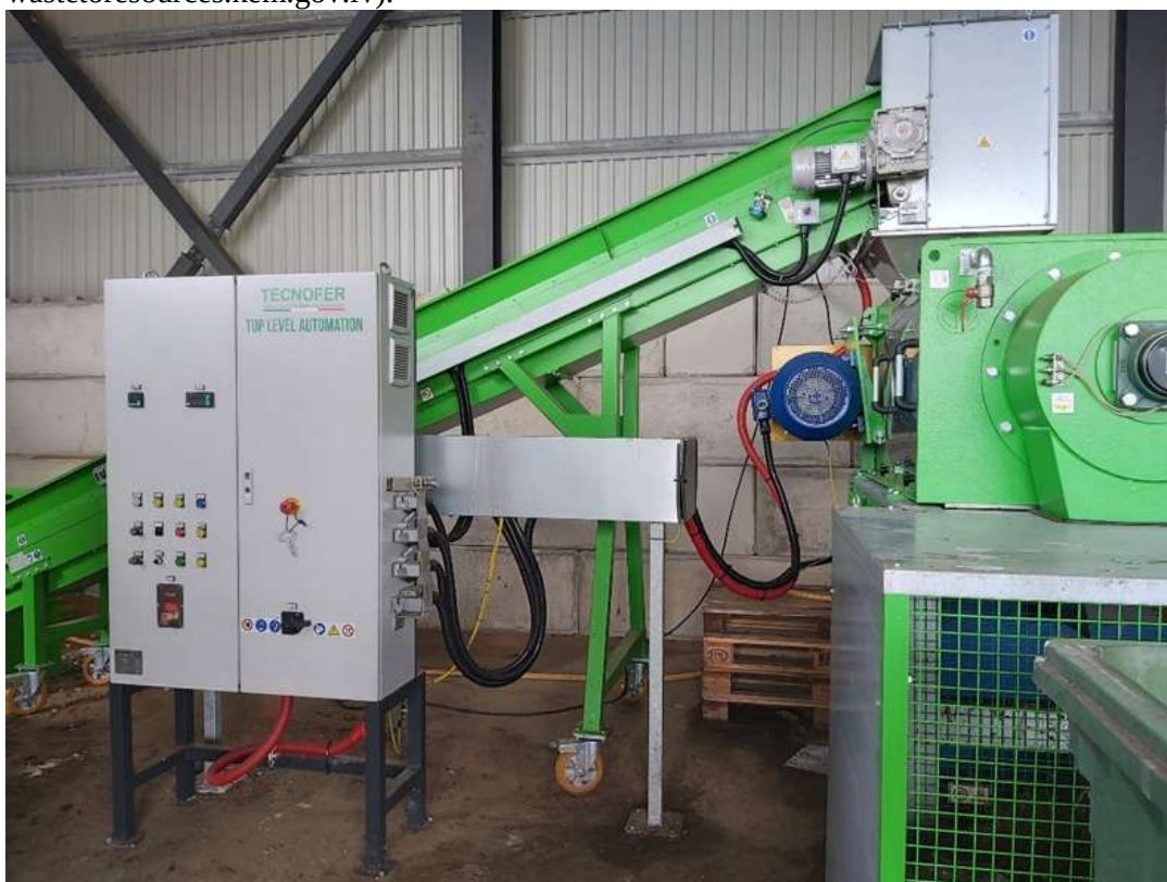
5.att. SIA “ZAAO” uzstādītā pārtikas iepakojuma mehāniskās atdalīšanas iekārta, lai sagatavotu kvalitatīvu masu biogāzes iegūšanas iekārtā (foto: LASA).
